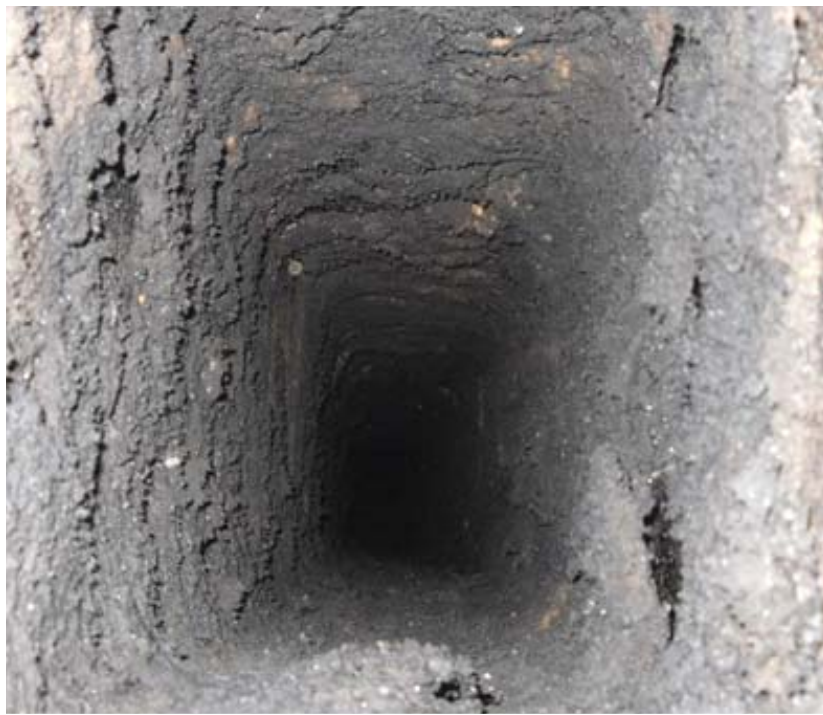
Canna fumaria in laterizio con deposito di fuliggine
