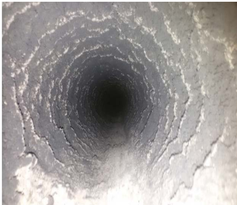
Canna fumaria in acciaio con deposito di fuliggine
