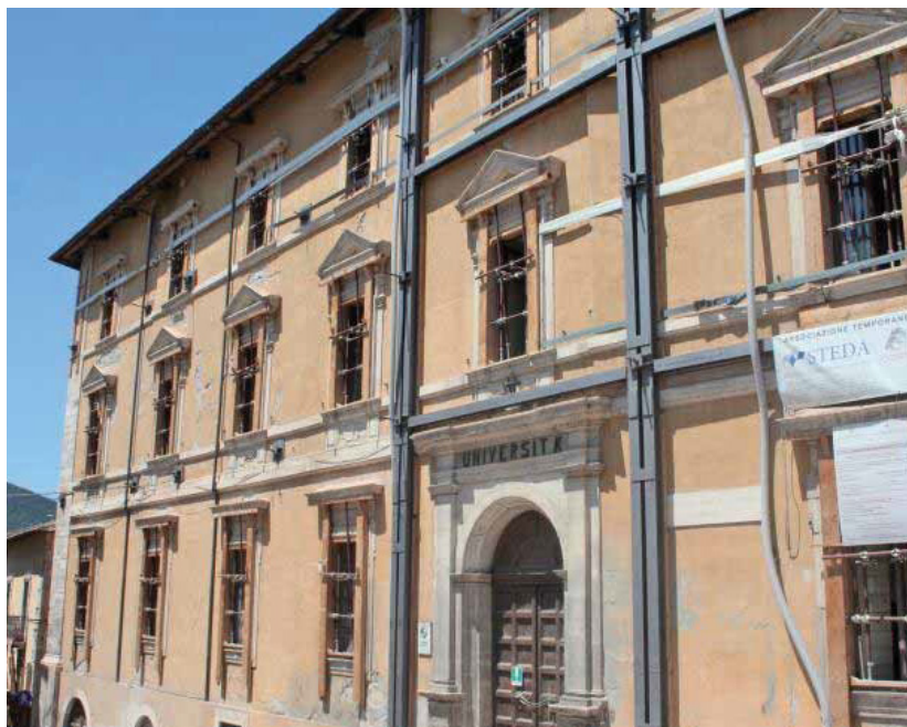
Cerchiature metalliche dell'edificio
